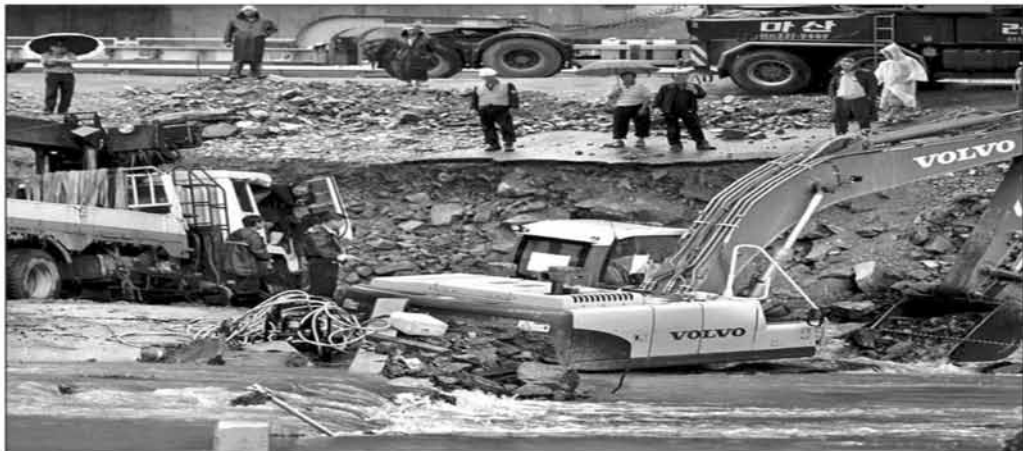
16일 호우특보가 내려진 경남 함안군 산인면모곡리 한 공사장에서 도로가 무너지면서 트럭이 빠지자 중장비가 동원돼 긴급 복구작업을 벌이고 있다. 함안 연합뉴스
